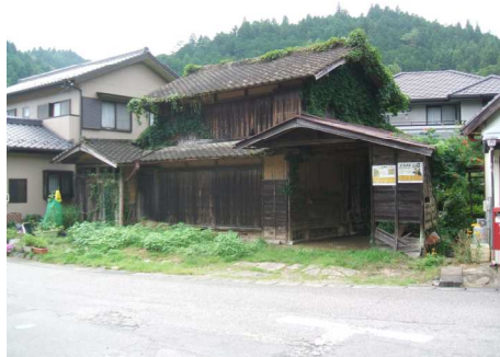
危険空家（解体前）
